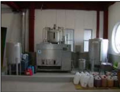
廃食油からバイオディーゼル燃料(BDF)を精製するプラント。 1回 200ℓの廃食油が精製できます。
