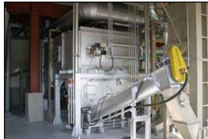
もみ殻を炭化するプラント。1日に約1トンのもみ殻を処理します。 排熱は、暖房や搾油等に利用します。
